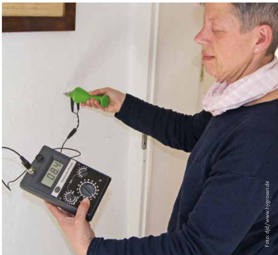
Erhöhte Feuchtigkeit in der Wand begünstigt das Wachstum von Schimmel. Messbar trockene Wände verhindern das zuverlässig.
